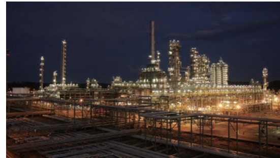
ガスプラント(サウジアラビア)
